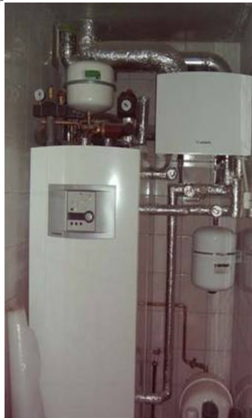
Wärmepumpe u. Lüftungsgerät im HWR
