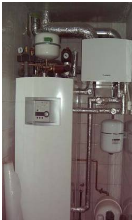
Wärmepumpe u. Lüftungsgerät im HWR
